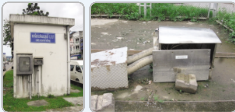
ภาพความเสียหายจากอุทกภัยของสถานีสูบน้ำและระบบควบคุมเครื่องสูบน้ำ ระบบบำบัดน้ำเสียเทศบาลนครหาดใหญ่ จังหวัดสงขลา
