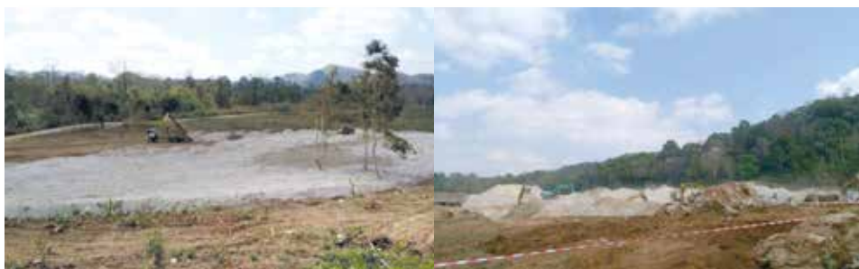
การเตรียมพื้นที่เพื่อก่อสร้างหลุมฝังกลบแบบปลอดภัยและการฟื้นฟูพื้นที่โดยรอบโรงแต่งแร่
