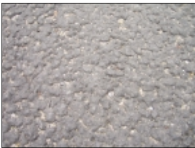
รูปที่ 38 ผิวทางแบบ มอดิไฟด์แอสฟัลต์คอนกรีต
