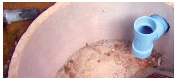
บ่อดักขยะ/ตะแกรงดักขยะ
