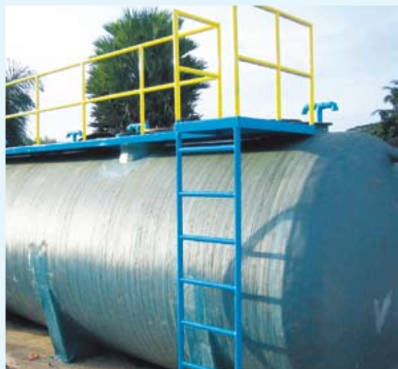
ระบบบำบัดน้ำเสียรวมขนาดเล็ก เทศบาลเมืองพัทลุง
