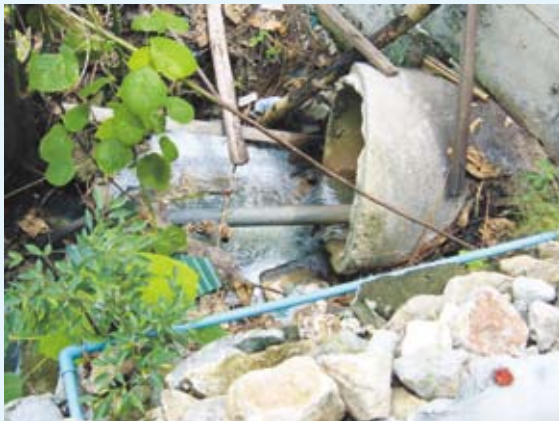
น้ำเสียจากท่อรวบรวมระบายลงสู่คลองจาก
