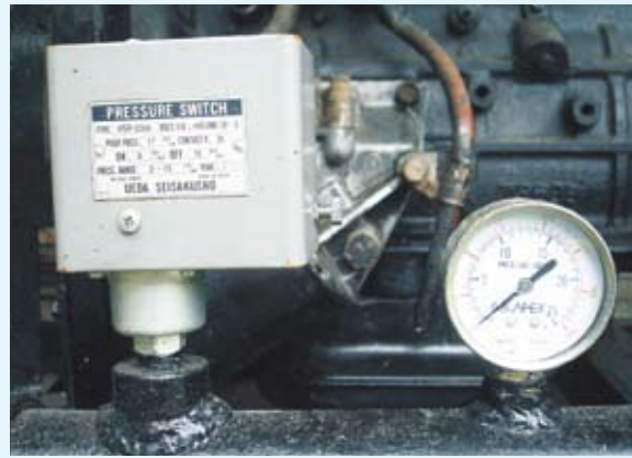
ชุดควบคุมแรงดัน
