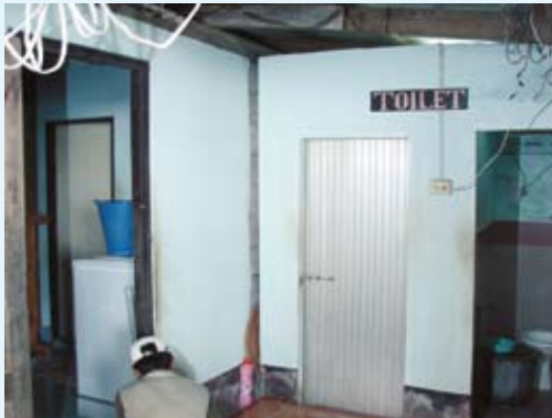
ห้องน้ำ-ห้องส้วม
