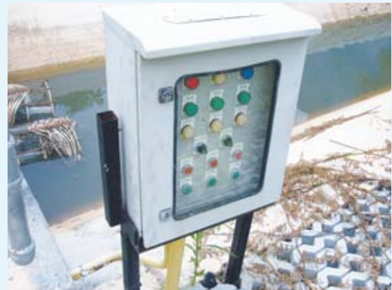
ตู้ควบคุมสถานีสูบน้ำเสียจากคลองจากเพื่อเข้าสู่ระบบฯ
