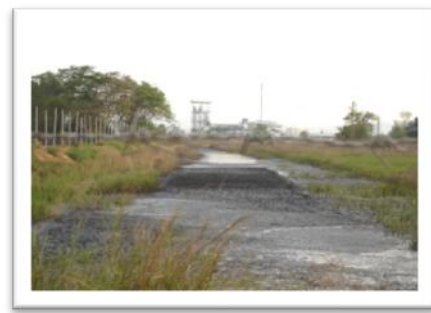
บ่อกักเก็บน้ำเสียของโรงงานอุตสาหกรรม
