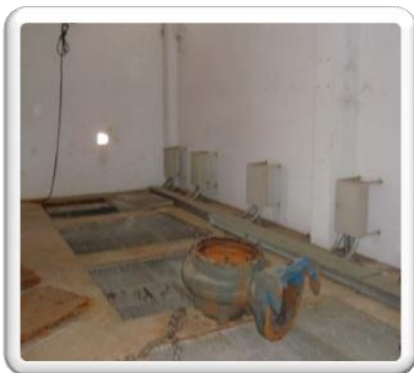
สถานีสูบน้ำเสียชำรุด
