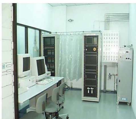
รูปที่ 4 ห้องควบคุม (Control Room)
