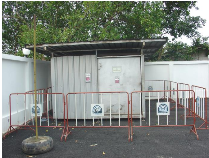
รูปที่ ๔ ห้องเก็บน้ำมันเชื้อเพลิง
