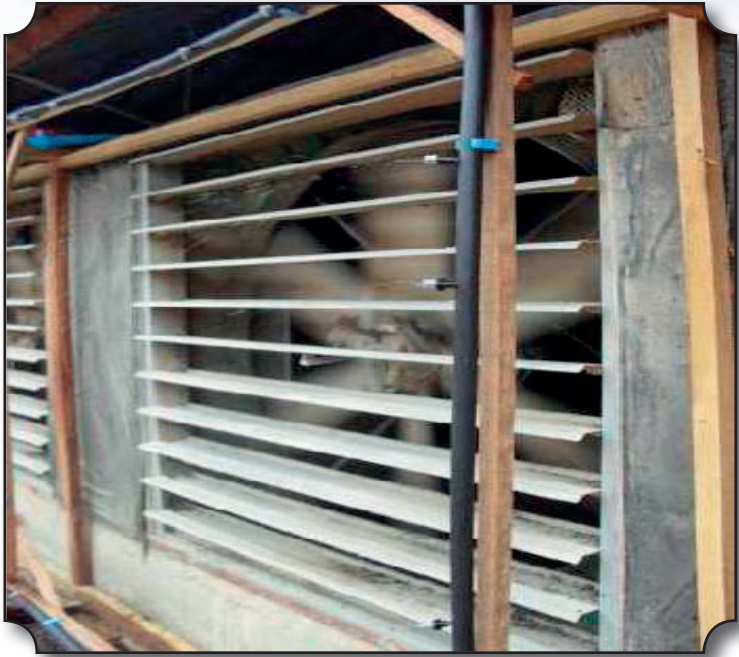
รูปที่ 4 การติดตั้งหัวสเปร์ย์น้ำ
