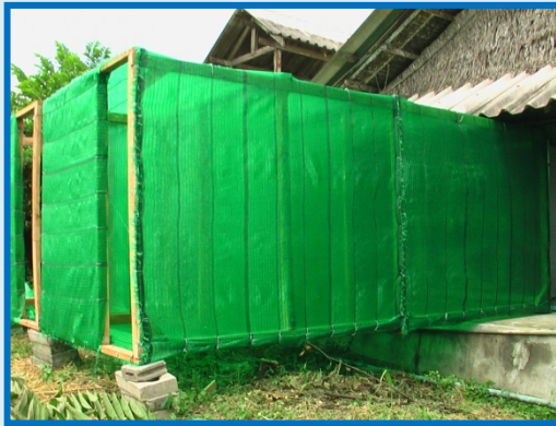
ระบบกำจัดกลิ่นแบบม่านกระจายน้ำและแผ่นกรอง
