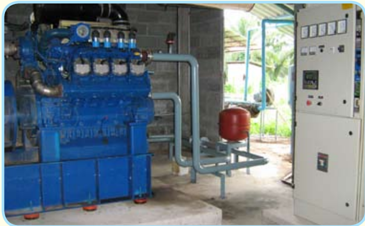
รูปการใช้ก๊าซชีวภาพกับเครื่องยนต์ที่ใช้ก๊าซชีวภาพ โดยเฉพาะเพื่อผลิตกระแสไฟฟ้า
