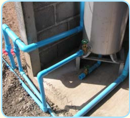
รูปแสดงจุดเปิดวาล์ว ถ่ายน้ำออกจากถังพักก๊าซ
