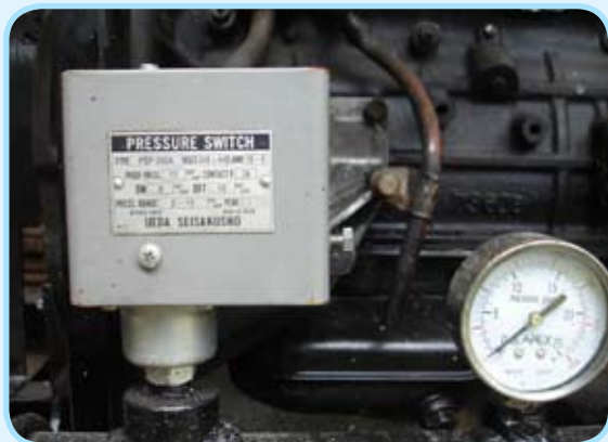
รูปแสดงชุดควบคุมแรงดัน
