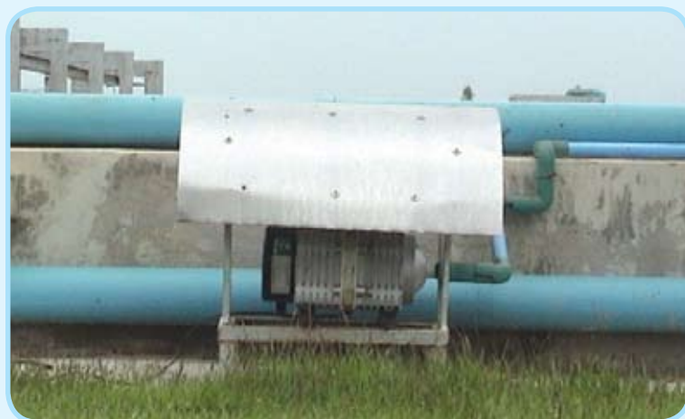
รูปการกำจัดก๊าซไฮโดรเจนซัลไฟด์ด้วยการเติมอากาศ
