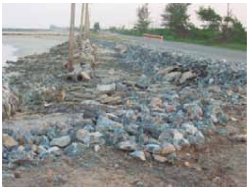
ความเสียหายของทางหลวง 4013 (กม.ที่ 17 - 21)
