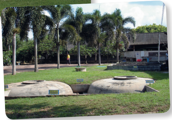
ระบบบำบัดน้ำเสียฟาร์มสุกร ▶
