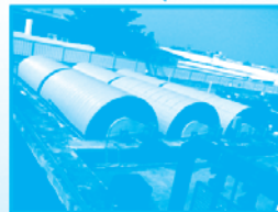
โรงบำบัดน้ำเสียแบบจานหมุนชีวภาพ (RBC) ระยะที่ 1
