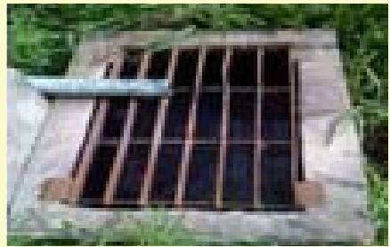
บ่อพักน้ำ
