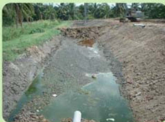
การปล่อยน้ำเสียเข้าบ่อบำบัด
