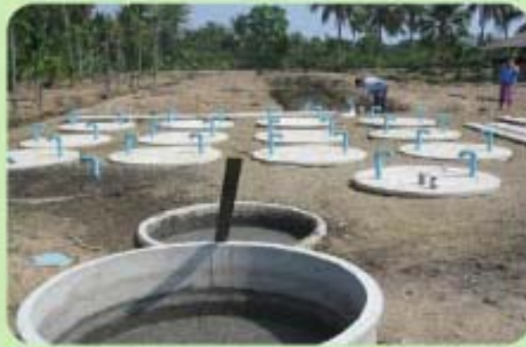
ระบบถังกรองไร้อากาศ
