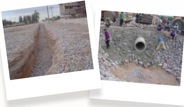
ภาพแสดงรางระบายน้ำ และบ่อดักตะกอนในบริเวณโรงโม่บดหรือย่อยหิน
