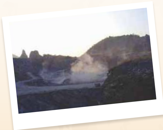
ภาพแสดงการระเบิดหินแบบถ่วงจังหวะ (Delay time)
