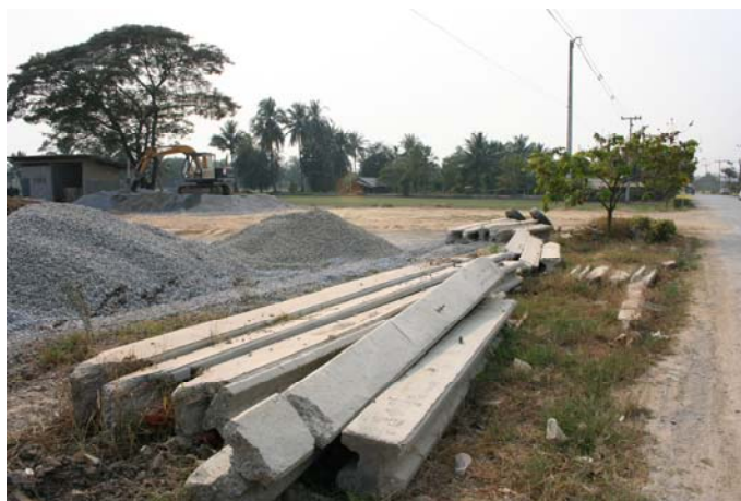
รูปที่ 2.2 ของเสียจากการก่อสร้างและรื้อถอนได้จากองค์ประกอบ โครงสร้างและผลิตภัณฑ์คอนกรีตและผ่านการคัดแยกแหล่งที่มา (สถานที่กองเก็บที่ 1) โดยที่ ก. เสาค้ำที่ถูกตัดออก ข. แผ่นพื้น ค. เสาค้ำหัก
