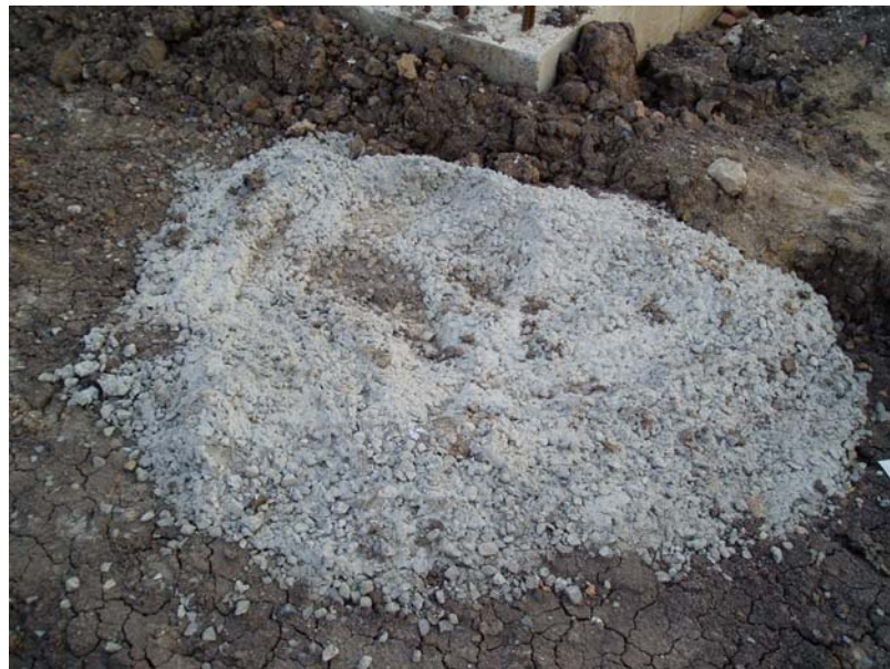
รูปที่ 5.4 เศษคอนกรีตผสมเสร็จที่เหลือจากรถขนส่งถูกเททิ้งในพื้นที่ก่อสร้าง
