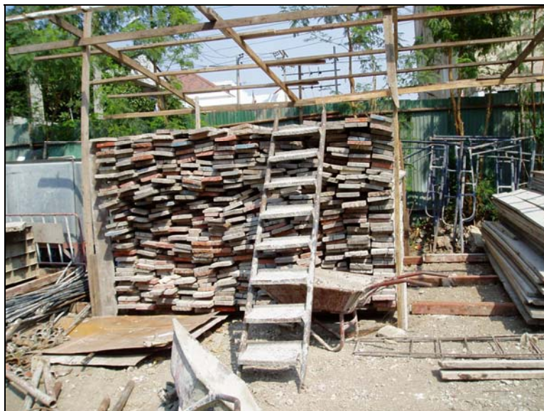
รูปที่ 5.9 ไม้แบบที่เก็บไว้ในสถานที่ก่อสร้างเพื่อรอนำกลับไปใช้ซ้ำ
