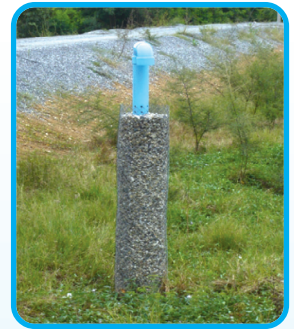
ท่อระบายก๊าซในพื้นที่ฝังกลบ
