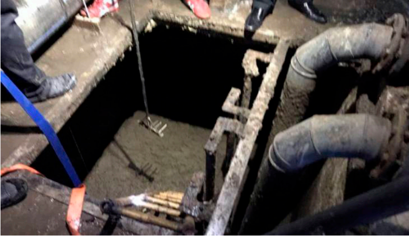
รูปที่ 1 บ่อรวบรวมน้ำเสีย ของบริษัทแห่งหนึ่ง
