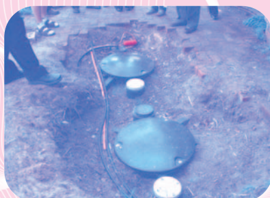
ถังกรองทรายเพื่อรับน้ำเสียจากบ้านพัก
