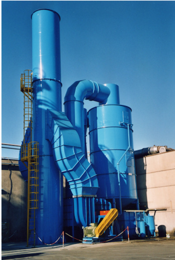
ระบบบำบัดอากาศแบบเปียก
