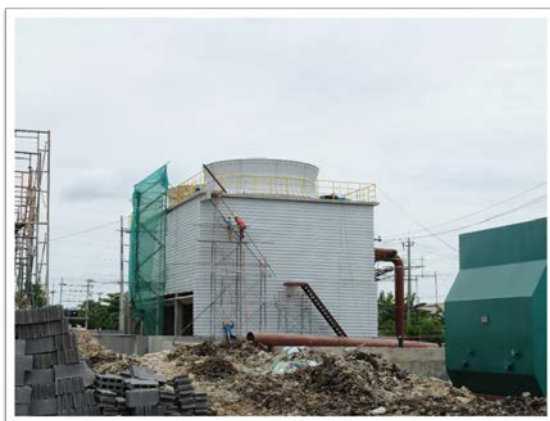
อาคารระบบหล่อเย็น
