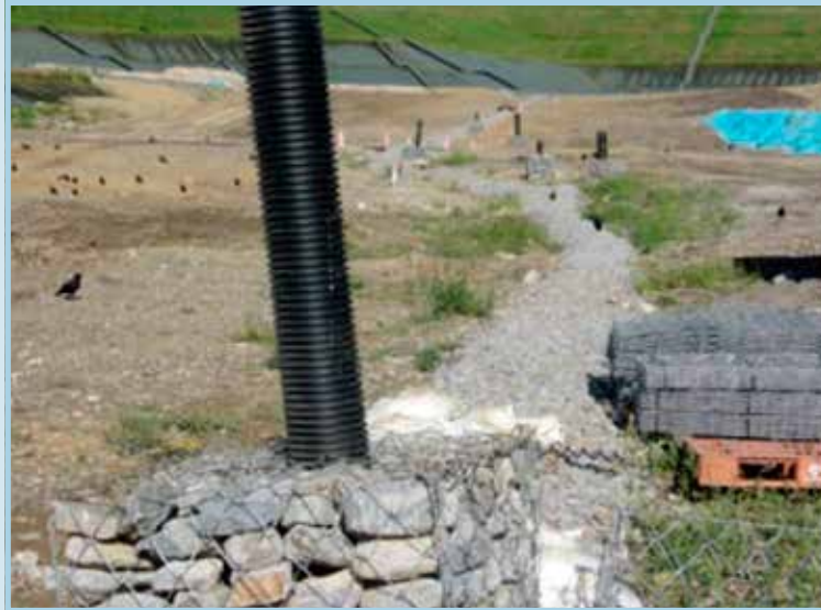
รูปที่ 20 ท่อระบายก๊าซที่อยู่เหนือบ่อฝังกลบขยะ
