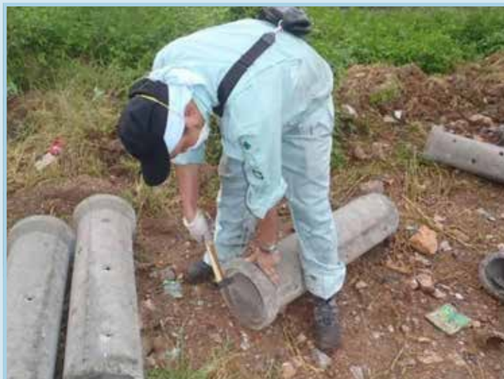
รูปที่ 31 การตรวจสอบรอยแตกร้าวของท่อรวบรวมน้ำชะขยะแต่ละท่อน
