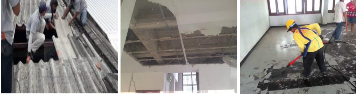
ภาพการรื้อถอน ซ่อมแซม และต่อเติมอาคารที่เมืองค์ประกอบของแรไยหิน
