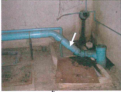
ท่อน้ำเสียเข้าระบบ
