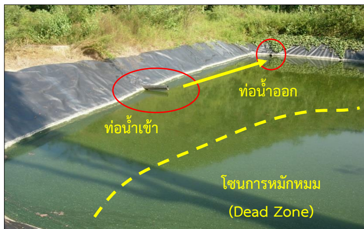
รูปที่ ๗ การวางตำแหน่งท่อน้ำเสียเข้าและท่อน้ำเสียออกที่ไม่เหมาะสม
