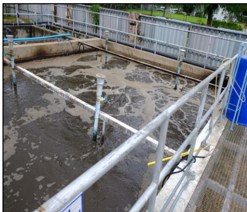
บ่อเติมอากาศ
