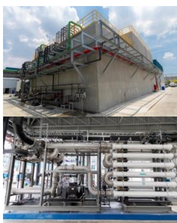
ระบบบำบัดแบบ MBR
