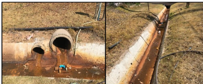
รูปที่ ๓ การระบายน้ำทิ้งลงรางระบายน้ำด้านหน้าบริษัท ที เอช เอช โมลิโพรเซสซิ่ง จำกัด
