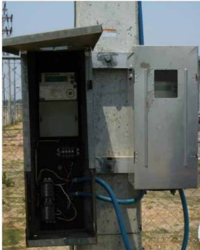
มิเตอร์ซื้อไฟฟ้าและมิเตอร์ขายไฟฟ้า
