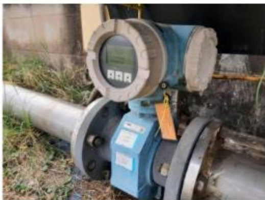
Flow meter วัดปริมาณน้ำเสีย
