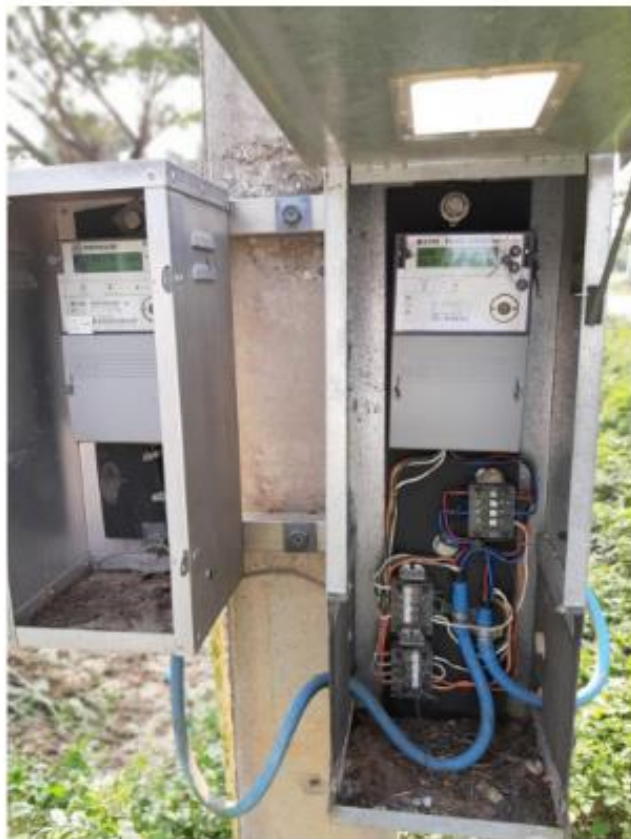
มิเตอร์ซื้อไฟฟ้าและมิเตอร์ขายไฟฟ้า
