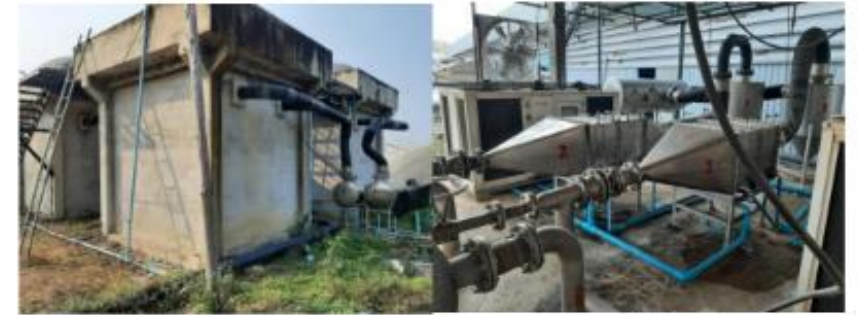
ระบบกำจัด H 2 S และความชื้น
