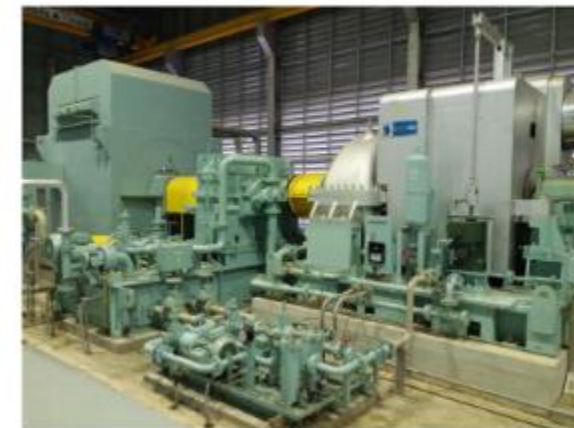
กังหันไอน้ำและเครื่องกำเนิดไฟฟ้า
