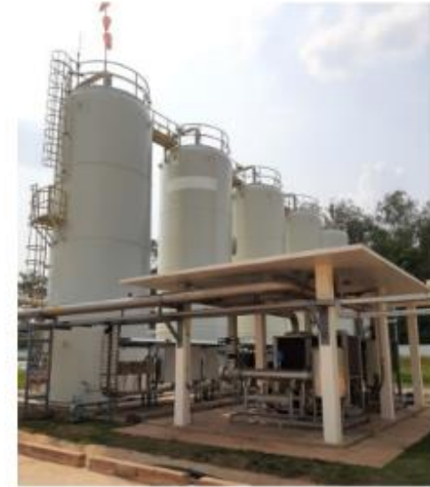
ระบบกำจัด H 2 S และความชื้น
