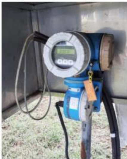
Flow meter วัดปริมาณก๊าซ
