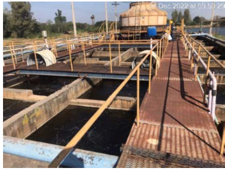
ระบบบำบัดน้ำคอนกรีตเสท
