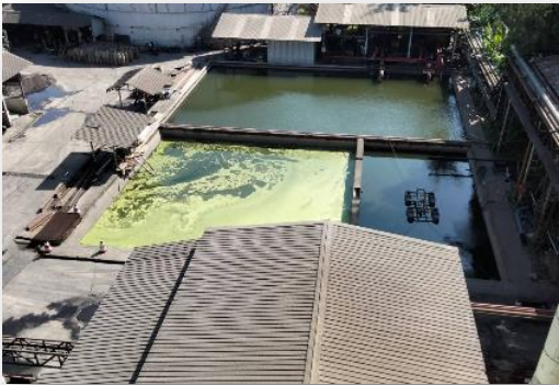
บ่อบำบัดน้ำเสียระบบบ่อเติมอากาศ
