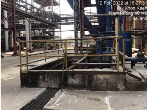
บ่อแยกน้ำมัน (Oil Separator)
