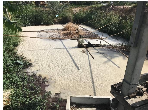
รูปที่ 4 ระบบบำบัดน้ำเสียโรงงานฆ่าสัตว์
