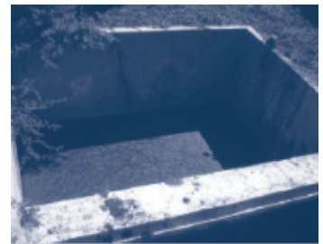
บ่อรวบรวมน้ำเสีย
