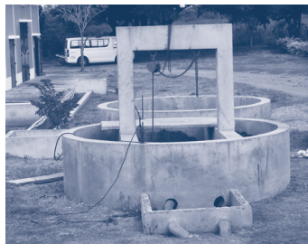
บ่อรวบรวมน้ำเสีย
