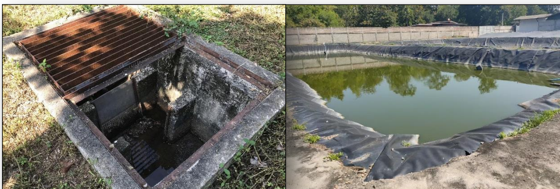
รูปที่ 3 ระบบบำบัดน้ำเสียโรงงานฆ่าสัตว์
