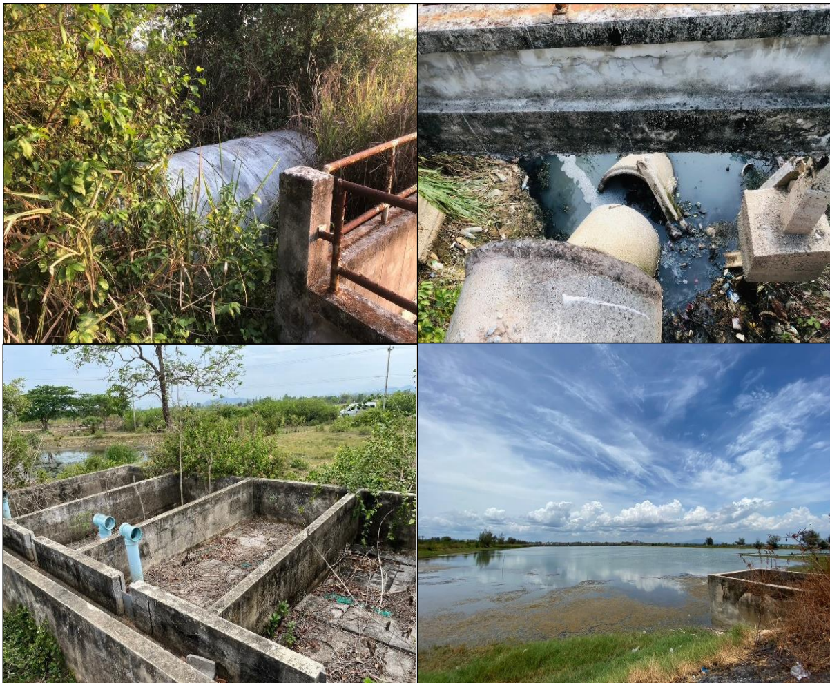
รูปที่ 1 ระบบบำบัดน้ำเสียที่ขาดการดูแลรักษา
